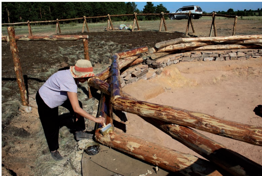
5-сур. Ағаштан тұрғызылған қабырғаны сақтау шаралары. Сурет Ж.К. Сұлтанжановтікі Fig. 5. Preservation measures for a wall built of wood. Photo by Zh. Sultanzhanov Рис. 5. Меры по сохранению стены, возведенной из дерева. Фото Ж.К. Сұлтанжанова
